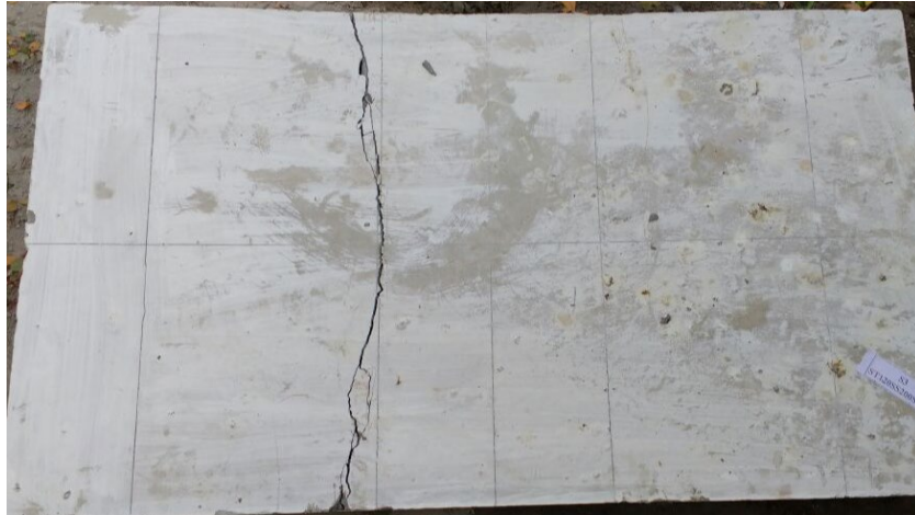
Fig. 17. Transverse crack in FST2SS1 composite slab
